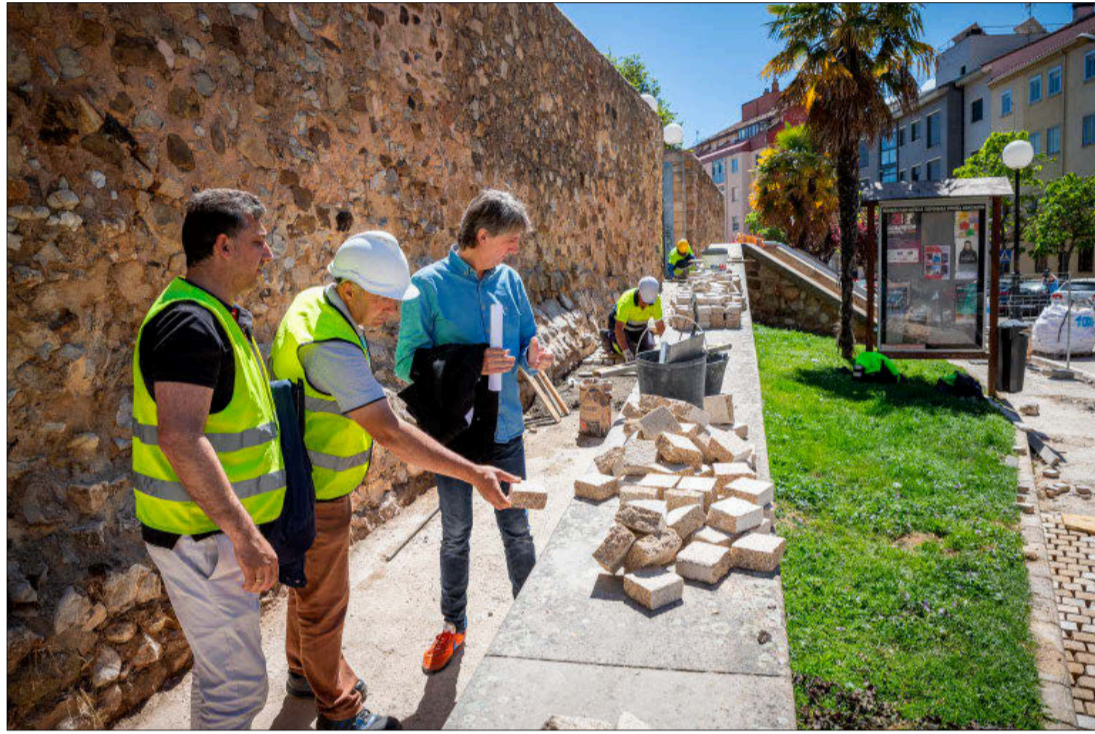
El alcalde de Soria, Carlos Martínez, visita las obras de las aceras de Santa Clara. MONTESEGUROFOTO
