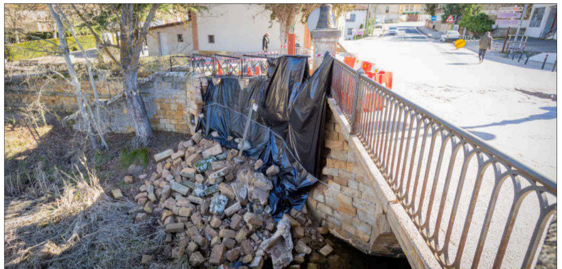
Estado que presentaba el puente tras el paso de la borrasca Juan. MARIO TEJEDOR
